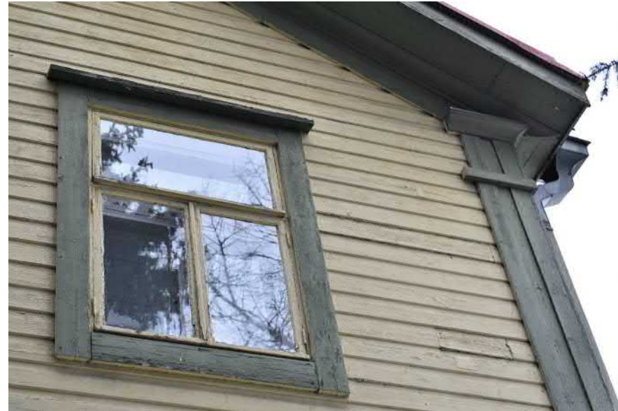
Kuva: Nurkkapilasterin kapiteeliosa ja umpiräystäään profiloitunut kattolistat. Vanha peltinen suppilo ja syöksytorni. Yläkerran T-karmillinen sisään-ulos -aukeava ikkuna. Suorat vuorilaudat ja ylävuorilaudan kallistettu vesilauta.
