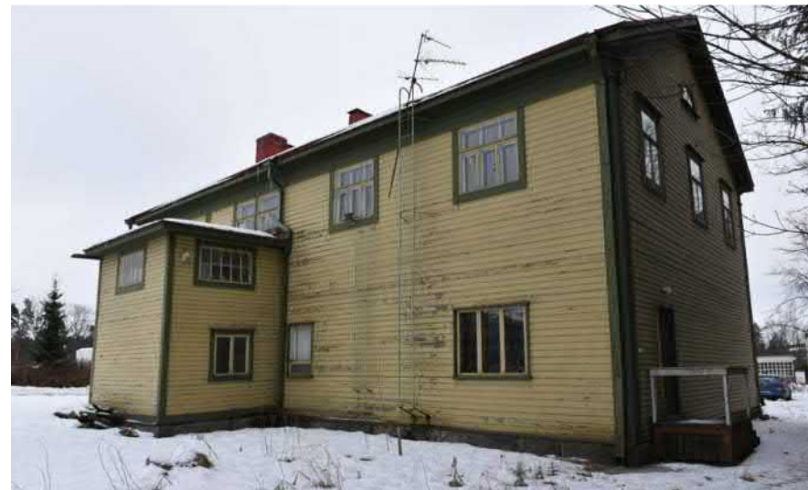
Kuva: Talon tällä sivulla alakerrassa on nyt 50-luvun ikkunat, mutta paikalla oli ennen rungon sisäpuolinen lasiveranta. 50-luvun ikkunoiden kehys on tehty kapeilla syvillä listoilla vuorilautojen sijaan. Porrashuoneessa pikkuruutuisten ikkunoiden saranat ovat yläreunassa.
