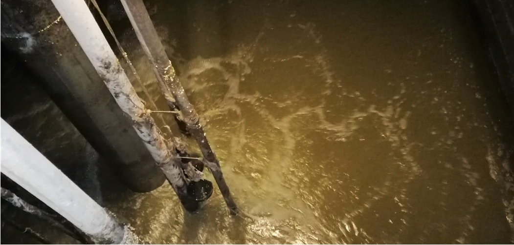
Jätevettä Honkapirtin jätevedenpumppaamolla
