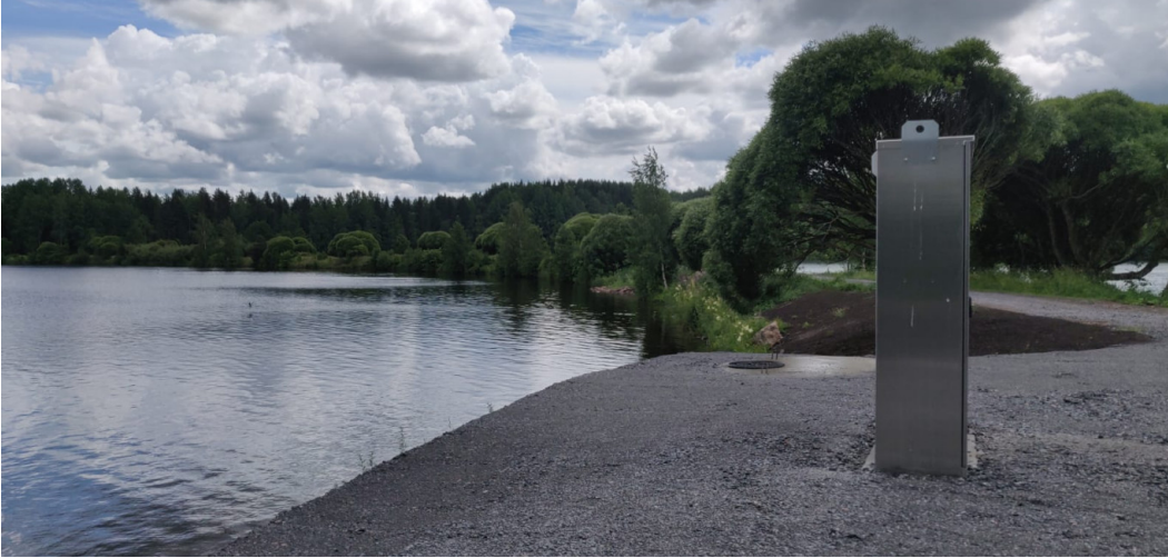
Mellonlahden pumppaamon sähkökaappi
