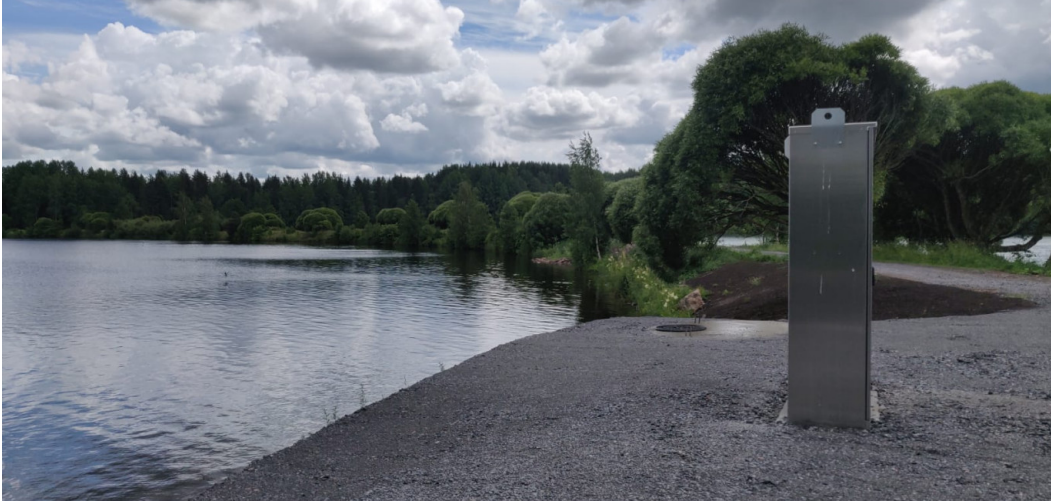
Mellonlahden pumppaamon sähkökaappi
