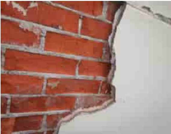
Paikoin rappaus on tippunut ja myös tiilimuuraus on pintarapautunut.
