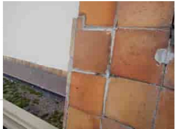
Ulokkeellisen julkisivuosan laattoja on havaintojen mukaan paikoin uudelleen kiinnitetty.
