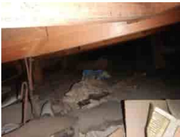
Vesikaton tuuletustilassa havaittiin kaikenlaista jätettä.
