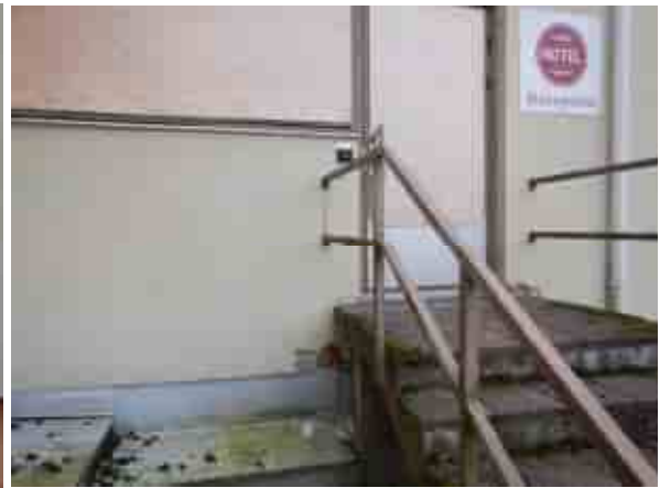
Sisäänkäynnin yhteydessä on rappauksen lohkeamia.
