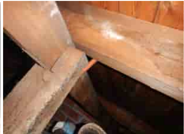
Vesikaton puurakenteissa havaittiin lievää kasvustoa, joka viittaa ainakin jossain vaiheessa tuuletuksen toimimattomuuteen.
