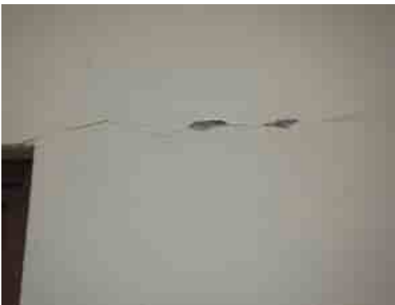
Aukotusten yhteydessä esiintyi yleisesti rappauksen halkeilua ja halkeamien yhteydessä kopoa.
