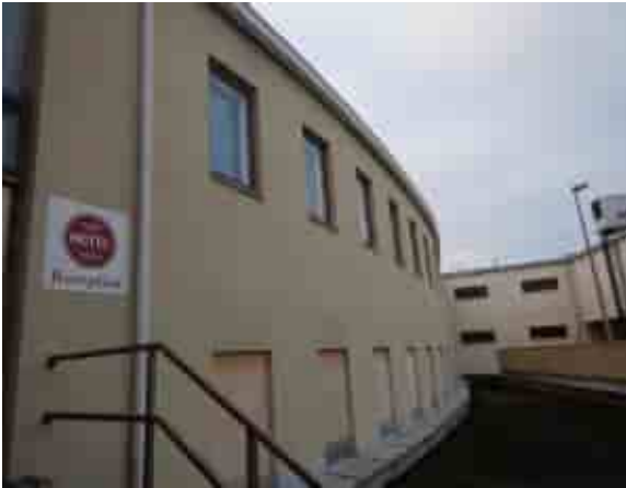
Kaarevan osan julkisivu vaikutti myöhempänä korjatulta, mutta siinä havaittiin muita julkisivurappauksia vastaavia vaurioita.
