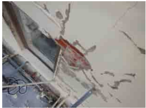
Paikallisesti rappauksessa voimakasta verkostomaista halkeilua.
