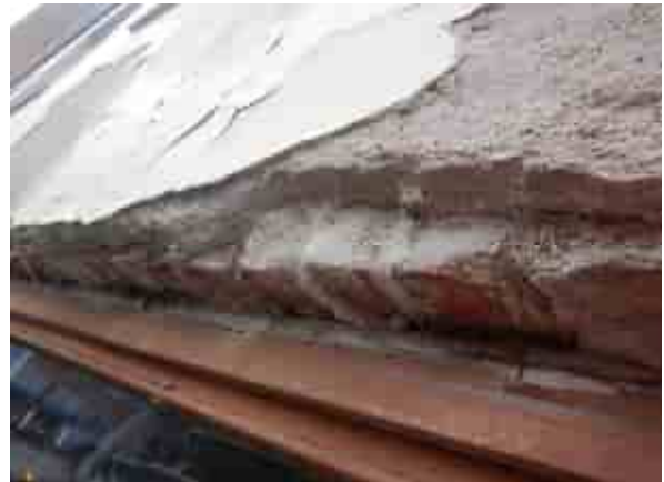
Rappauksessa on paikallisesti lohkeamia. Rappauksesta otettiin yksi näyte ohuthietutkimuksiin arviolta vaurioitumattomasta alueesta.
