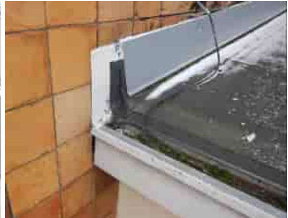
Kaikilla vesikattoalueilla havaittiin räystäskouruissa roskaa ja sammaloitumista. Rakennus ei ole saatujen tietojen mukaan ollut vuosiin käytössä ja huoltokin on näin ollen ollut puutteellista.
