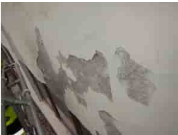
Julkisivun rappauksessa on paikoin pintavaurioita. Pinnassa on suhteellisen yleisesti havaittavissa verkostomaista halkeilua.
