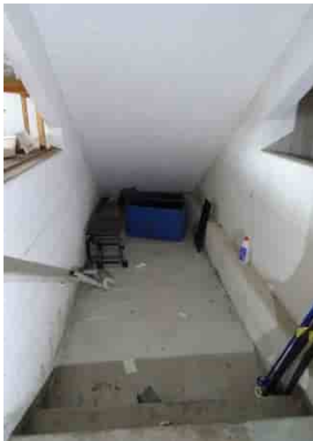
Kuva 111. 2. kerroksen varastotilojen ummistettu porrassyöksy. Kuvaaja: Marjo Tauriainen 20.3.2024
